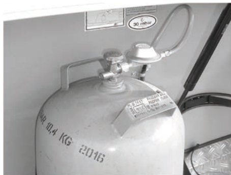
Kuva 68: kaasupullo, jossa matalapainesäädin ja matalapaineletku
