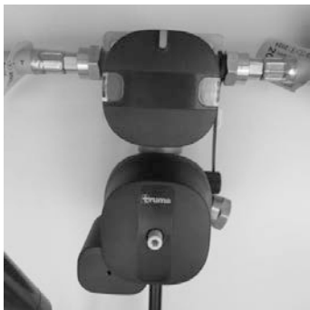
Abb. 74: Gasversorgung (mit Eis-Ex und Fernanzeige)
