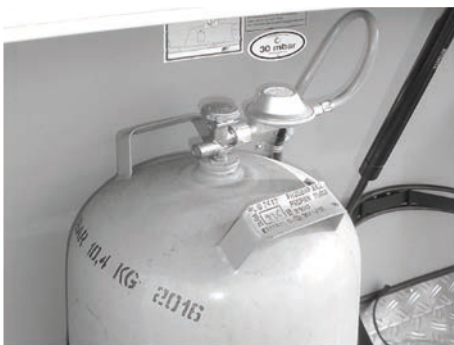
Abb. 73: Gasflasche mit Niederdruckregler und Niederdruckschlauch
