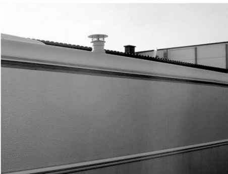
Abb. 77: Abgaskamin der Gasheizung
